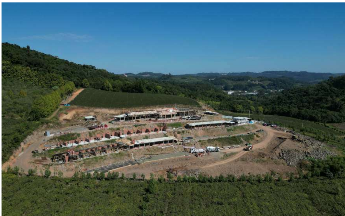
Obras em Bento Gonçalves encontram-se aceleradas e o primeiro resort brasileiro dentro de uma vinícola no Brasil será entregue em novembro de 2025
